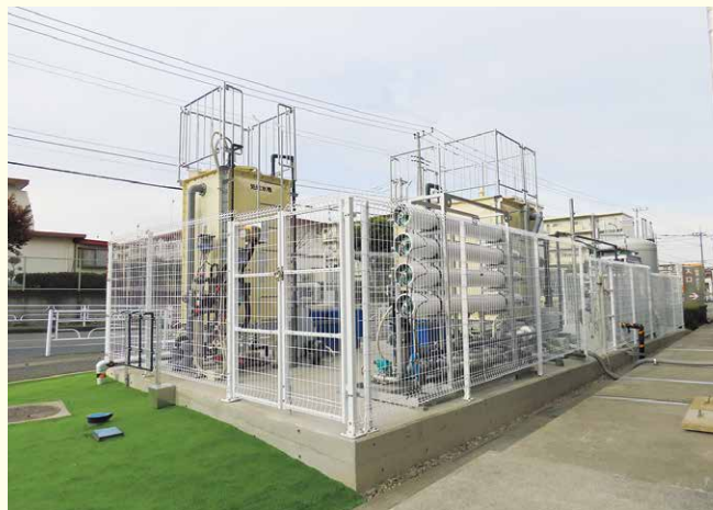
「地下水膜ろ過システム」
