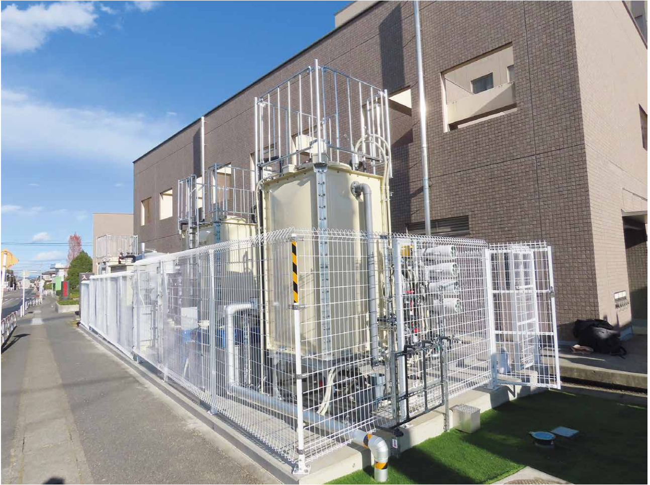
地下水膜ろ過システム [令和2年12月15日 病院正面入口の右側に設置] ※本誌6ページにて紹介。
